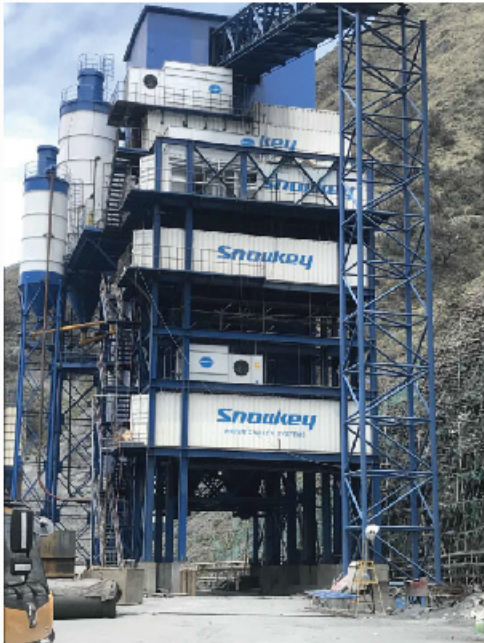
葛洲坝集团整体式制冷楼含制冰、冷水、骨料二次风冷
