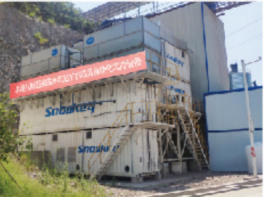
水电八局五强溪骨料风冷系统
