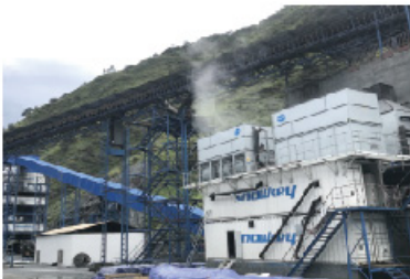
两河口水电站（一次风冷+二次风冷+制冰站+冷水站）
