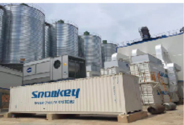
广西西津水利枢纽项目（一次风冷+冷水站）
