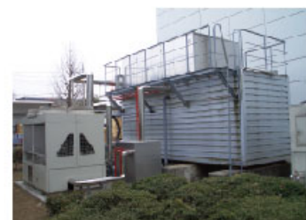
蓄冷工程 (板冰、流态冰)
